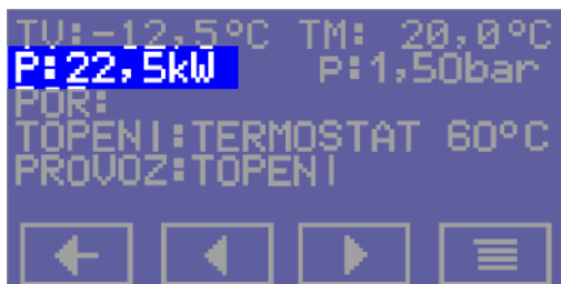
P: OKAMŽITÝ VÝKON KOTLE
